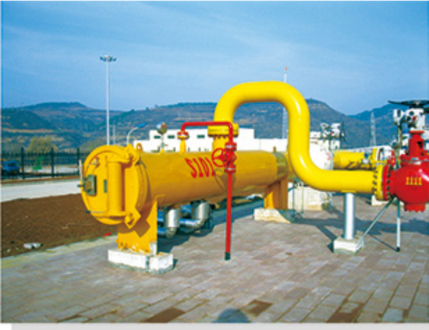
西气东输沁水站
